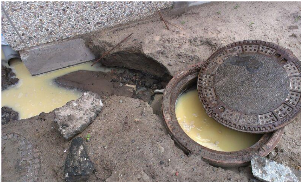
Foto: Verzakking in het rioleringsysteem.
