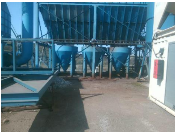
Foto 20 Ontstoffingsinstallatie brander/mengers(27 maart 2020)
