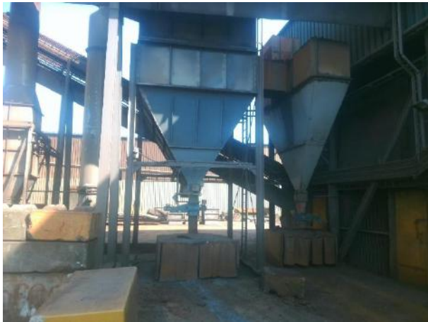
Foto 20 Ontstoffingsinstallatie shredder à fines (27 maart 2020)
