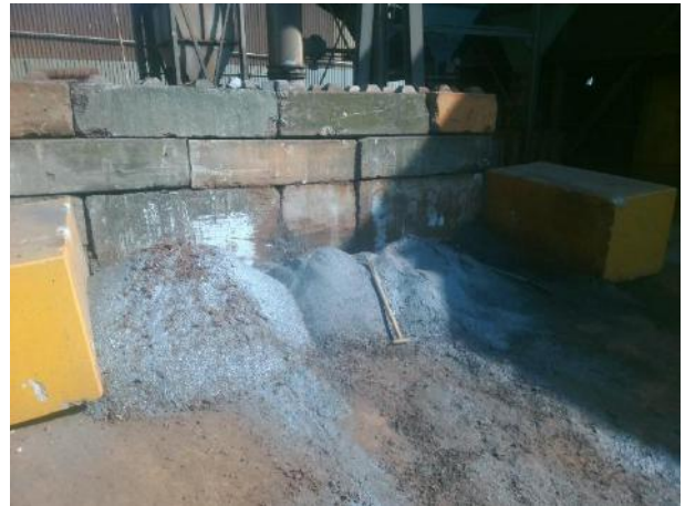
Foto 21 Ontstoffingsinstallatie shredder à fines (27 maart 2020)
